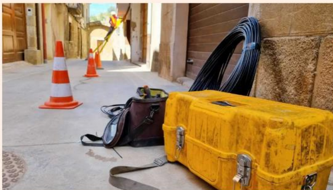
Cables de fibra óptica utilizados en el despliegue de la red de telecomunicaciones de un pueblo de Ciudad Real.
